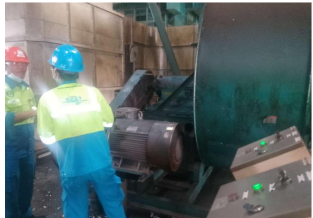
Gambar 2. Lokasi Motor yang Berbahaya.
